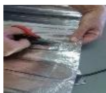
Konec stříhu. POZOR na kabel!
