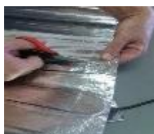
Konec stříhu. POZOR na kabel!
